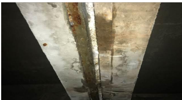
F7 – Infiltração localizada junta etapas 1/2
