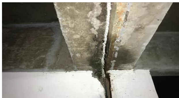
F8 – Infiltração localizada junta etapas 1/2
