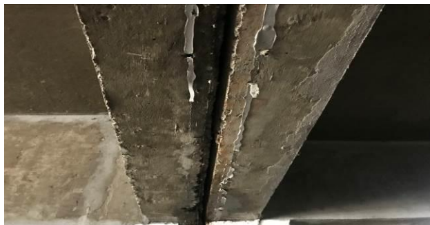
F9 – Infiltração localizada junta etapas 1/2
