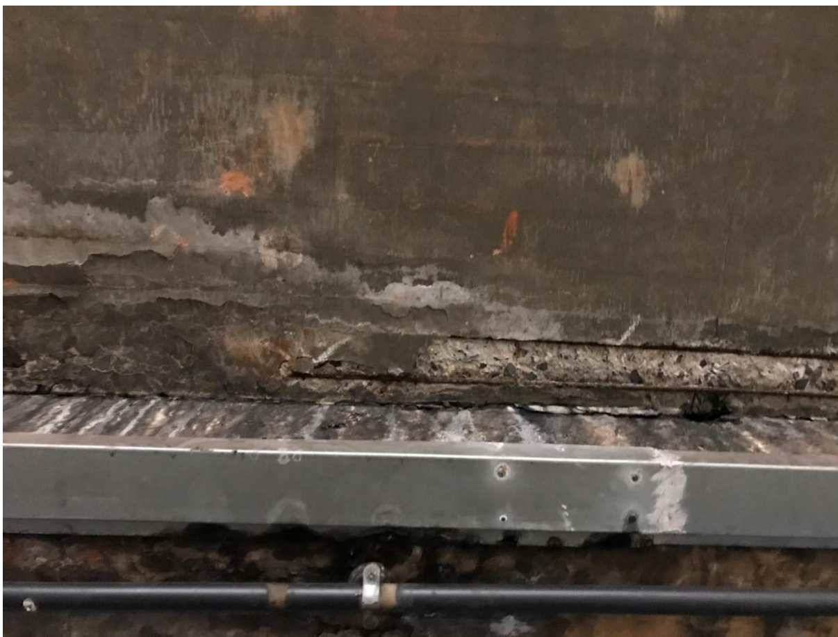
F11 – Estado precário do concreto e da ferragem da junta em frente a rampa
