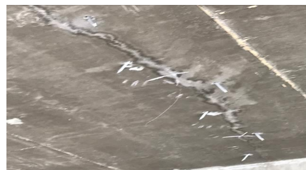
F16 – Recuperação fissuras na laje de teto sobre as vagas 472/473
