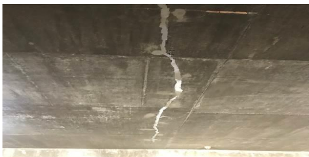
F9 – Recuperação fissuras na laje de teto sobre as vagas 464/465
