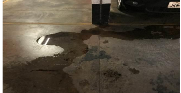
F26 – Infiltração pela junta durante os testes na etapa 2
