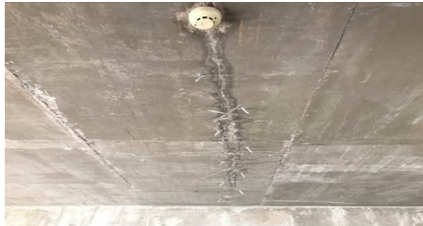
F18 – Recuperação fissuras na laje de teto sobre as vagas 478
