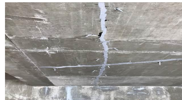
F14 – Recuperação fissuras na laje de teto sobre as vagas 472/473
