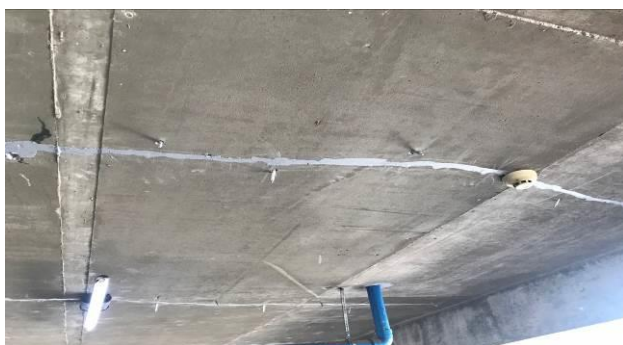
F11 – Recuperação fissuras na laje de teto sobre as vagas 470/471
