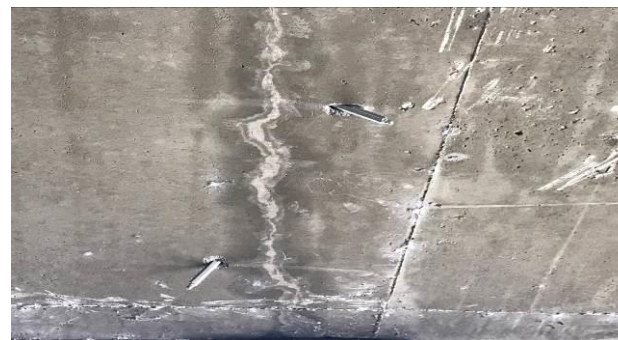
F20 – Recuperação fissuras na laje de teto sobre as vagas 478
