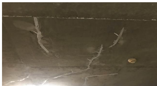
F7 – Recuperação fissuras na laje de teto sobre as vagas 392/393
