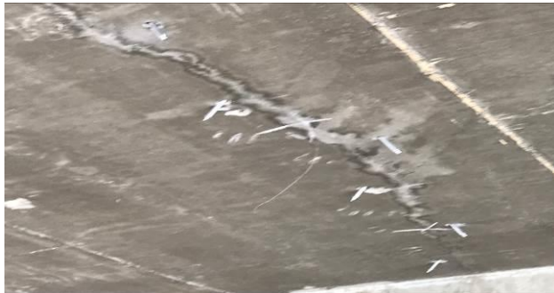
F17 – Recuperação fissuras na laje de teto sobre as vagas 476
