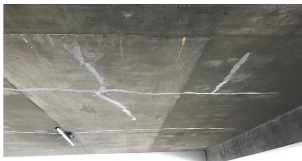
F10 – Recuperação fissuras na laje de teto sobre as vagas 466/467
