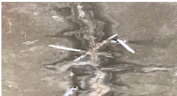
F19 – Recuperação fissuras na laje de teto sobre as vagas 478
