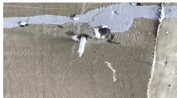
F12 – Recuperação fissuras na laje de teto sobre as vagas 470/471
