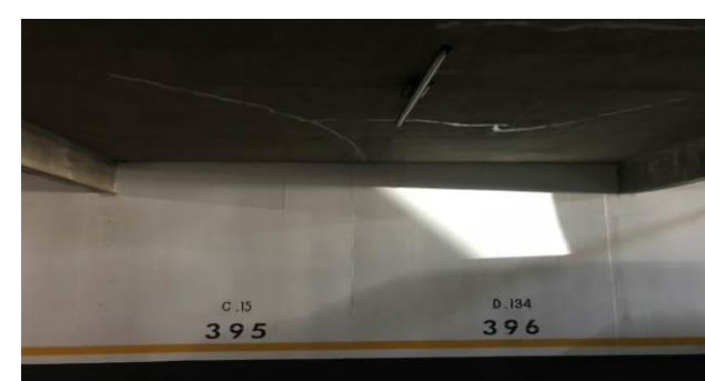
F8 – Recuperação fissuras na laje de teto sobre as vagas 395/396
