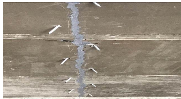
F13 – Recuperação fissuras na laje de teto sobre as vagas 470/471
