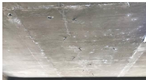
F21 – Recuperação fissuras na laje de teto sobre as vagas 478
