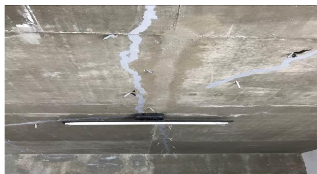
F15 – Recuperação fissuras na laje de teto sobre as vagas 472/473
