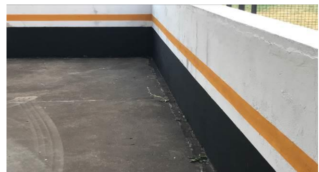
F12 – Junta entre piso e mureta
