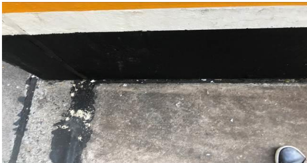
F9 – Junta calafetação entre piso e mureta
