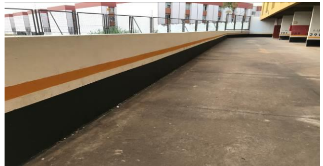
F10 – Junta entre piso e mureta
