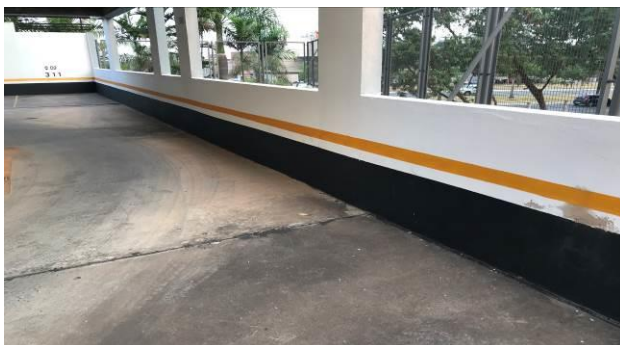
F13 – Junta entre piso e mureta
