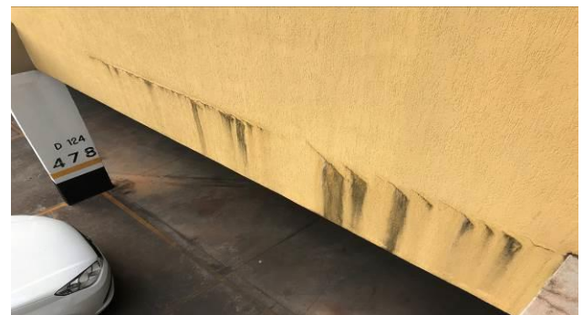
F14 – Infiltração e trinca na mureta
