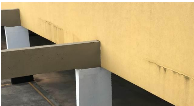
F15 – Infiltração e trinca na mureta
