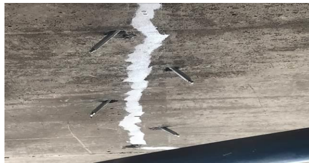
F10 – Vista fissura e bicos de injeção
