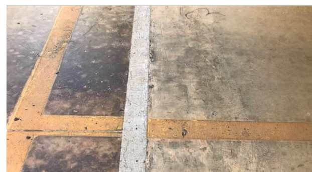
F12 – Junta de piso tratada com junta Jeene e poliuretano
