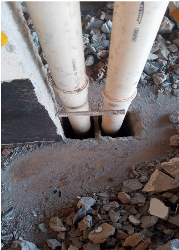
F16 – Dutos de água pluvial mal chumbados que deram origem ao vazamento na área de intervenção (foto cedida pela PIMAR)
