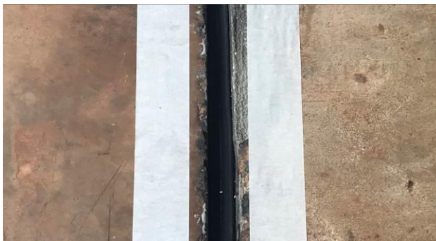
F11 – junta de dilatação da PARTE 2 em recuperação
