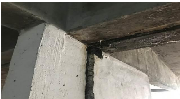
F7 – Vista do teto do 2º SS onde ocorreu vazamento localizado (junta de dilatação)
