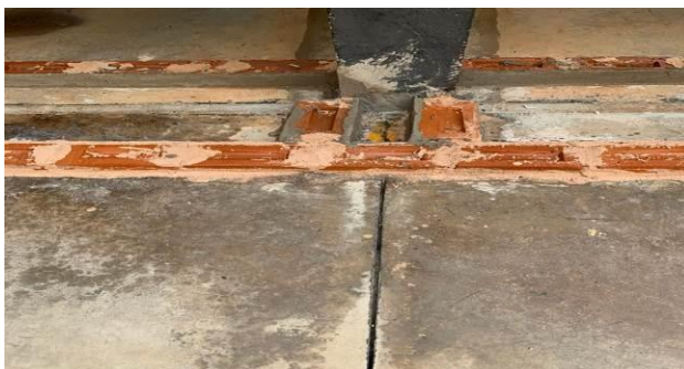
F13 – Infiltração em ponto localizado da junta (foto cedida pela PIMAR)
