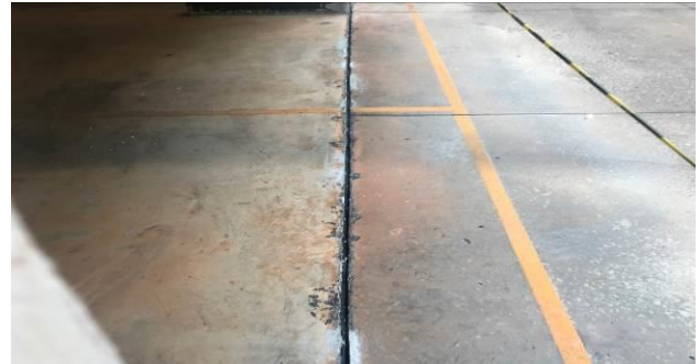
F10 – junta de dilatação da PARTE 2 em recuperação
