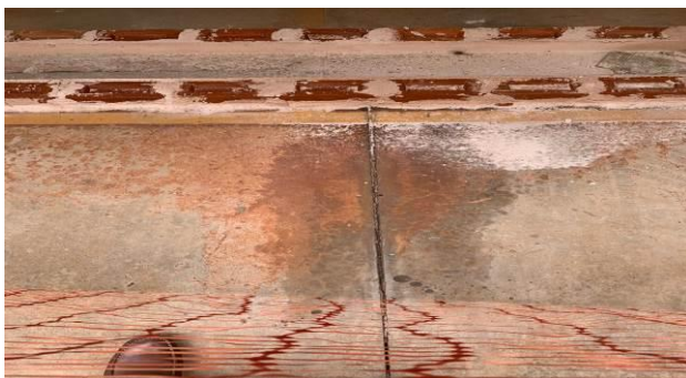
F15 – Infiltração em ponto localizado da junta (foto cedida pela PIMAR)
