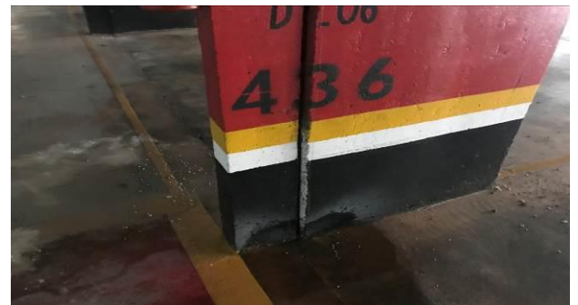
F8 – Vista vazamento localizado (juntas)
