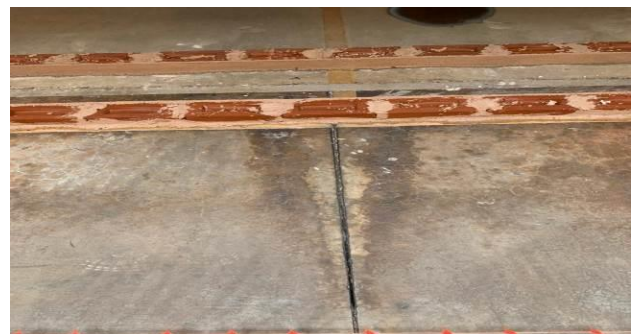
F14 – Infiltração em ponto localizado da junta (foto cedida pela PIMAR)
