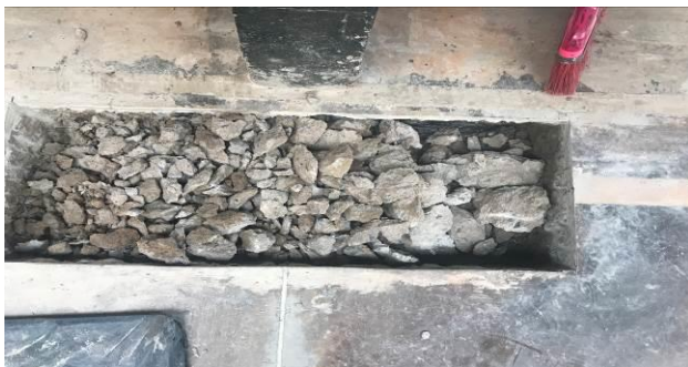
F9 – Abertura na junta da ETAPA 1 para identificar a origem do vazamento ocorrido
