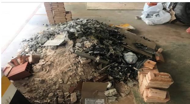
F15 – Entulho depositado no local
