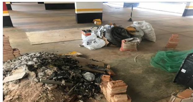
F14 – Entulho depositado no local
